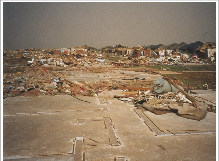
Bis auf die Bodenplatte zerstörtes Gebäude (T11) Tornado 03.05.1999 Moore, Oklahoma / USA (Foto: Mike Branick, NWSFO)
