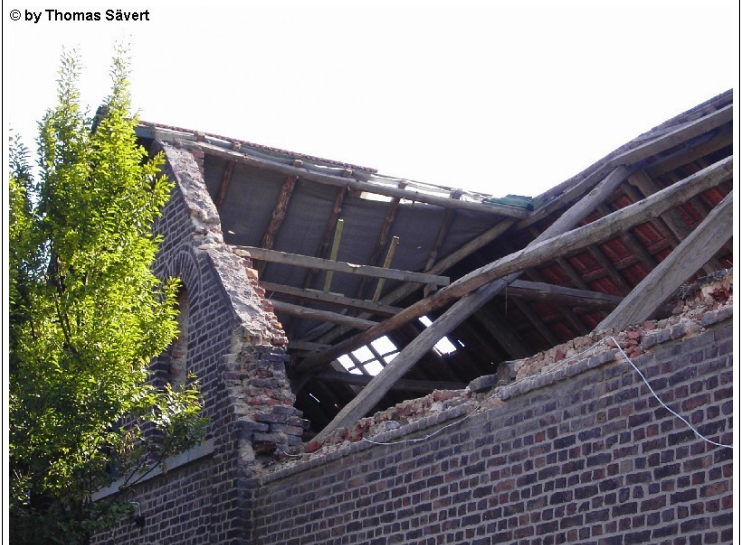
Ältere Dachkonstruktion teilweise zerstört (T5) Tornado 18.07.2004 - Tönisvorst / NRW (Foto: Thomas Sävert)
