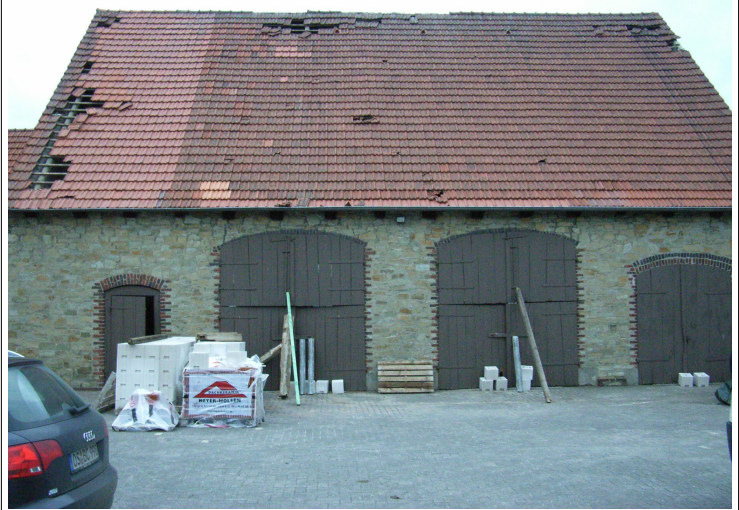
Dach teilweise abgedeckt (T2) Tornado 17.01.2007 - (Kyrill) Melle-Reimsloh / NRW (Foto: Martin Hubrig)
