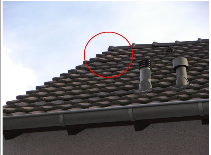
Dachziegel leicht verrutscht (T0) Downburst 18.01.2007 - (Kyrill) Pulheim / NRW (Foto: Erik Dirksen)
