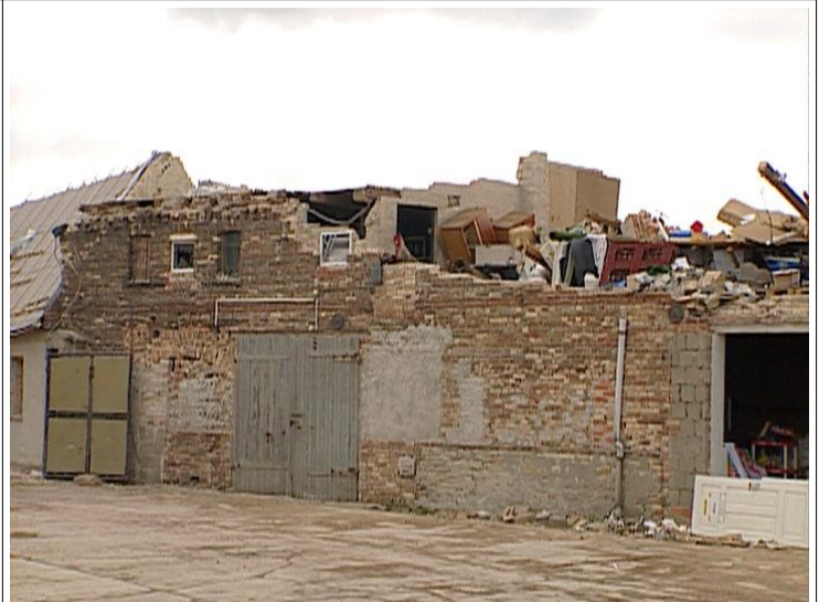
Komplette Zerstörung des Obergeschoßes eines Nebengebäudes (T7) Tornado 23.06.2004 - Micheln / Sachsen-Anhalt (Bild: Martin Hubrig)
