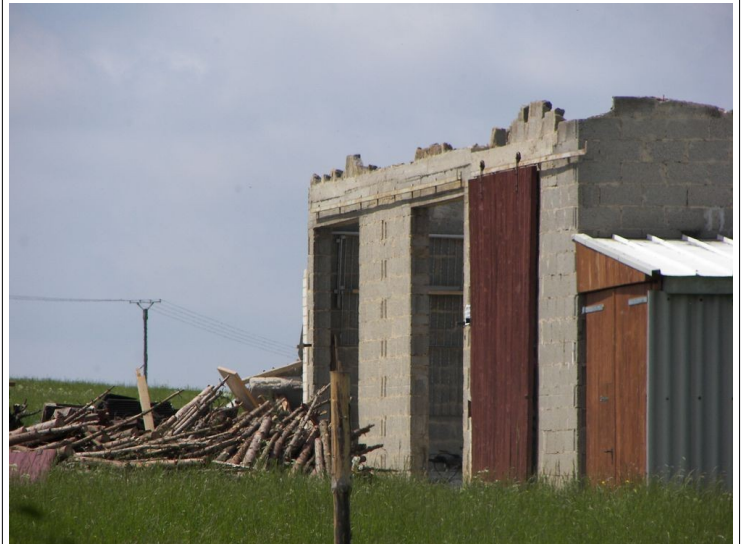
Zerstörte Feldscheune (T4) Tornado 13.05.2007 - Kall-Sistig / NRW (Foto: Erik Dirksen)
