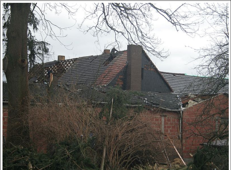
Dach flächig abgedeckt (T3) Tornado 01.03.2008 - Uttershausen / Hessen (Foto: Eyk Neidert)
