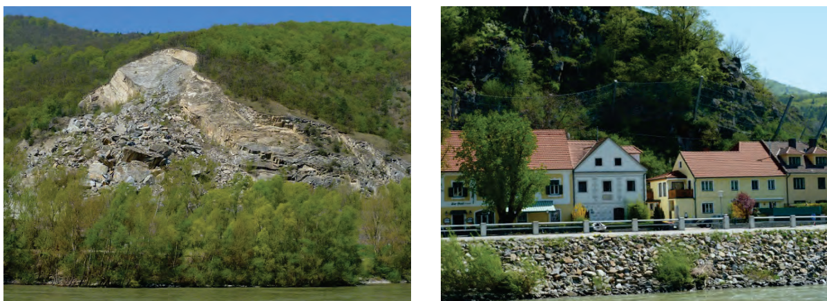
Abb. 9: linkes Bild: Felssturz von 1961 (initiales Gleiten) im Marmor (Moldanubikum) bei Spitz a. d. Donau aufgrund anthropogener Hangunterschneidung/Steinbruchbetrieb (vgl. SCHWENK, 1992); rechtes Bild: Steinschlag-Schutznetze an der Donau in Aggsbach-Dorf.
